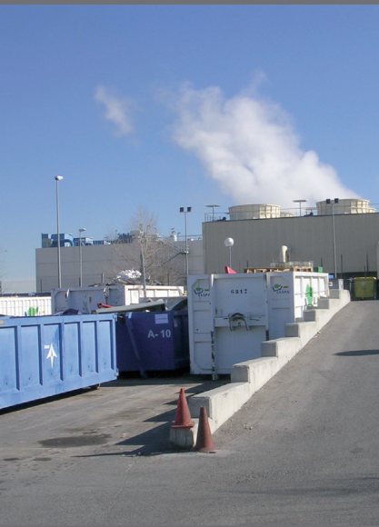
Planta de cogeneración. Autor: Carlos Iglesias
